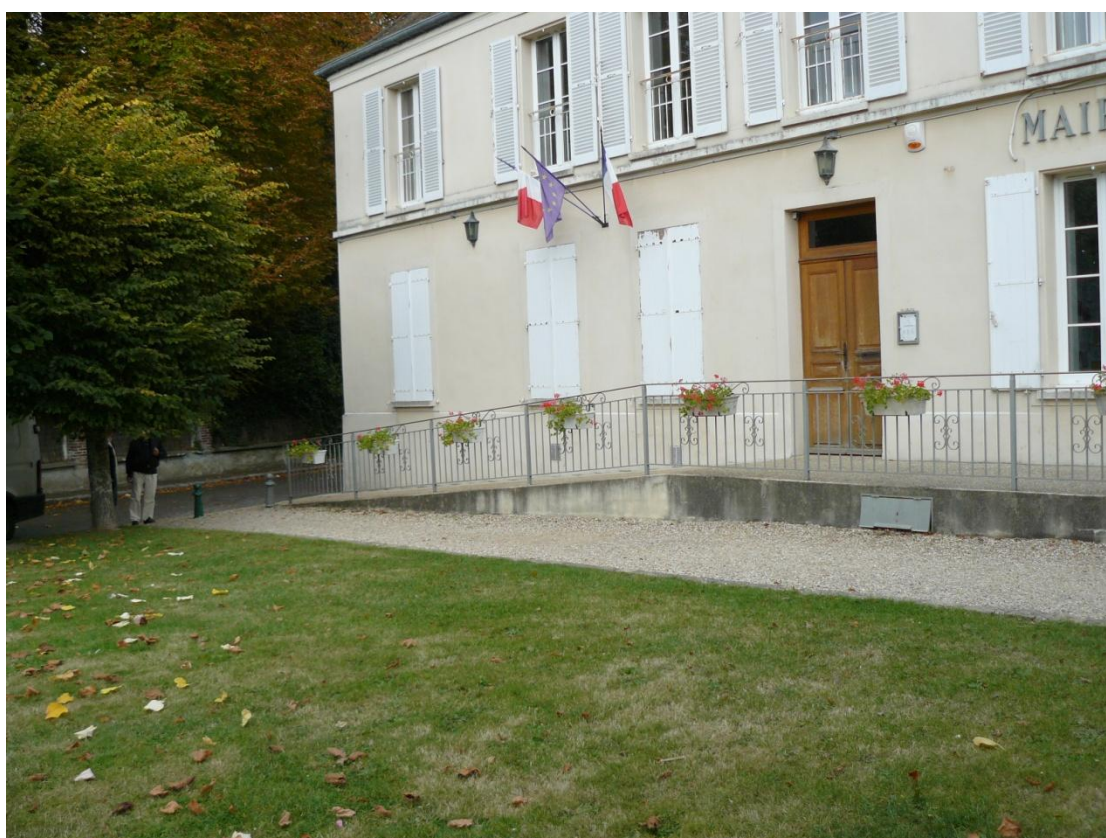
Garde-fou réalisé par notre atelier municipal
